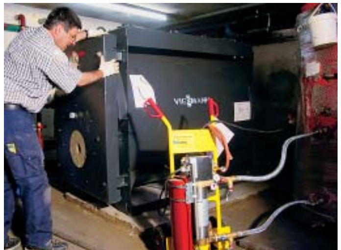
„... während das Laing S.O.S.Heizmobil bereits das Wasser im neuen Brauchwasserspeicher erwärmt“.
