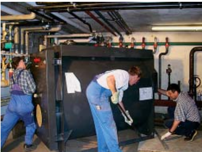
„Mit vereinten Kräften wuchten Herr Lempp (rechts) und seine Mitarbeiter den neuen Kessel für über 20 Wohnungen an die richtige Stelle...“
